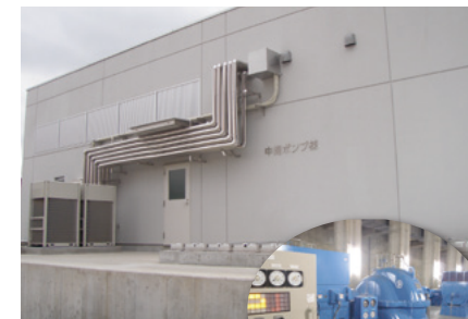
中間ポンプ施設
