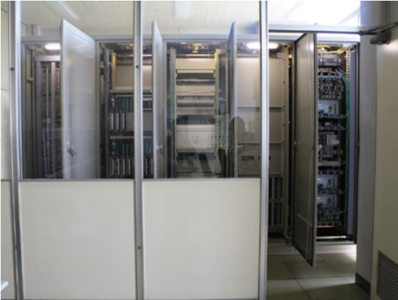
計算制御設備
