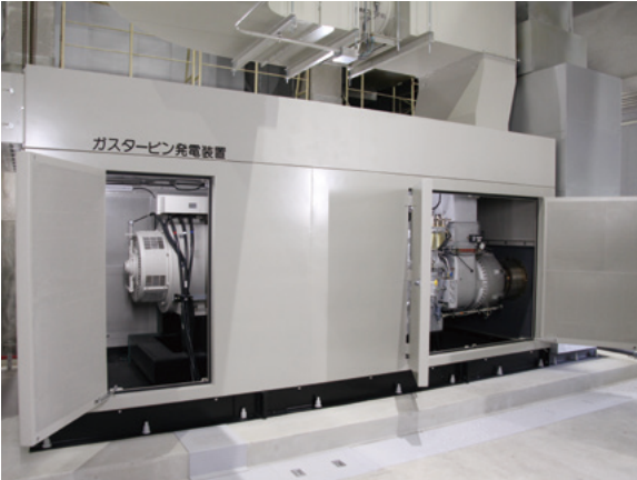
自家発電設備
