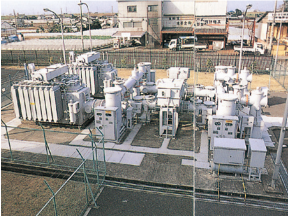
特高受変電設備
