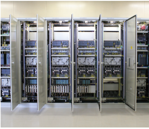
計算制御設備
