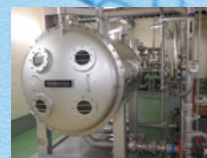
オゾン発生装置
