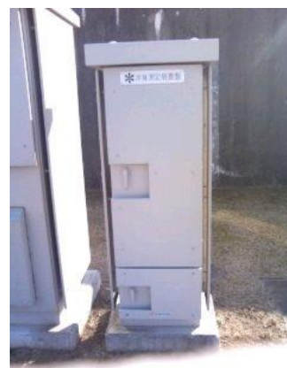
給水地点に設置した水質自動測定装置
