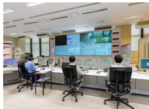
交代制勤務と外部委託による運転管理(浄水場)
