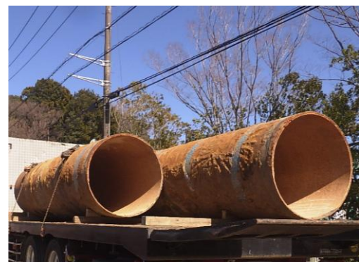
老朽化した管路の状況
