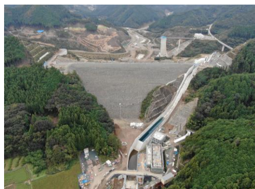
思川開発(南摩ダム)の建設状況 (提供: 独立行政法人水資源機構)
