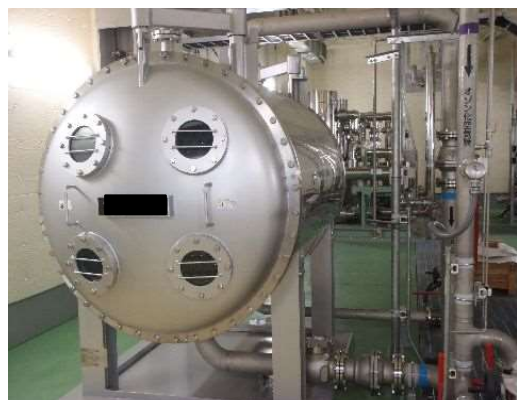
オゾン発生装置
