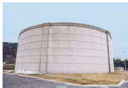
給水地点(構成団体受水槽)
