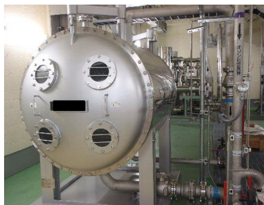
オゾン発生装置
