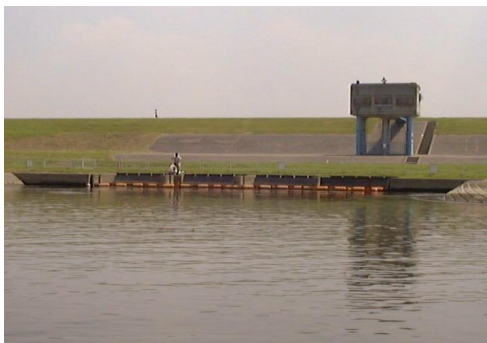
取水口(水道原水の取り入れ口)
