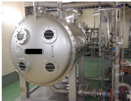
オゾン発生装置
