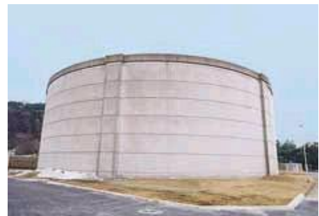
給水地点(構成団体受水槽)
