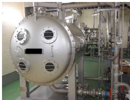
オゾン発生装置
