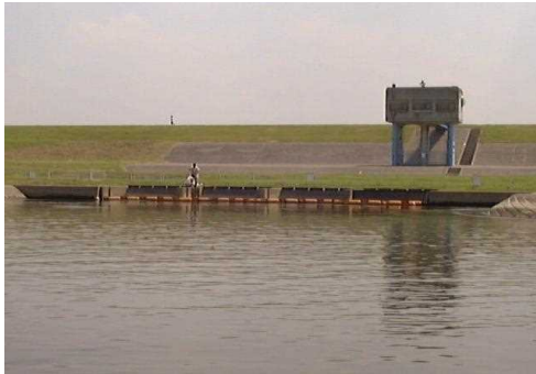
取水口(水道原水の取り入れ口)
