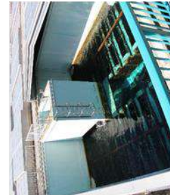
急速ろ過池 濁質分を除いたろ水を軟化水とするため、砂ろ過層を通過させ浄水する池。
