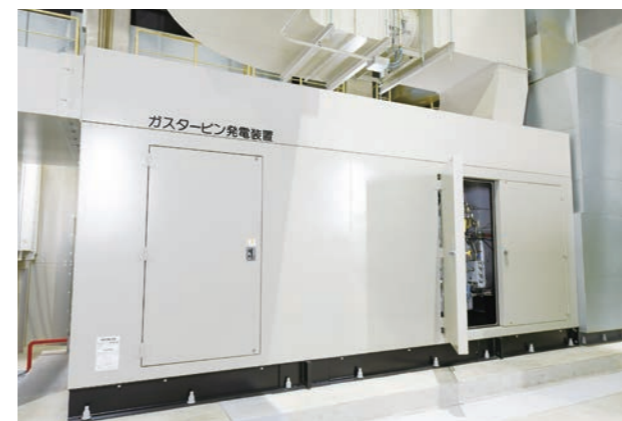
自家用発電設備 災害等で電力会社からの電源供給が途絶えた際に必要な電力を自前で賄うための発電装置で、取水場施設の1/2相当を2日間稼働させることができます。
