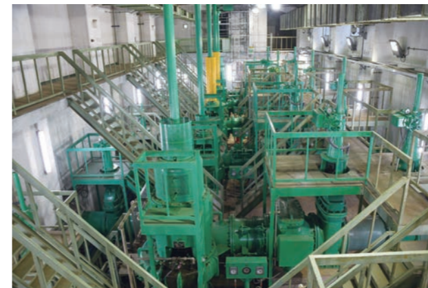
取水ポンプ 取水口から取り入れた原水を取水場から約5km離れた浄水場へ加圧して送ります。
