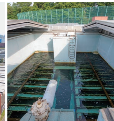
急速ろ過池（覆蓋開放状態）
