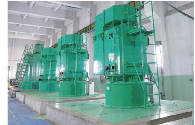
取水ポンプ電動機
