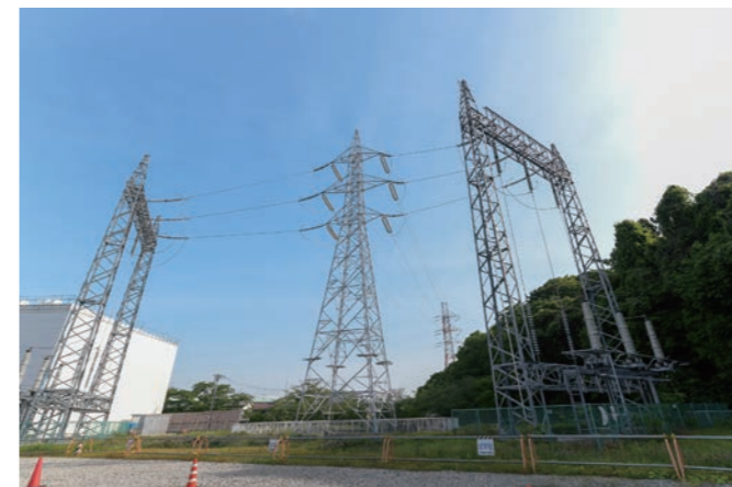
特高受変電設備
