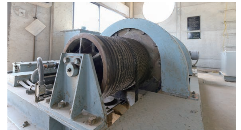
取水門ゲート開閉装置
