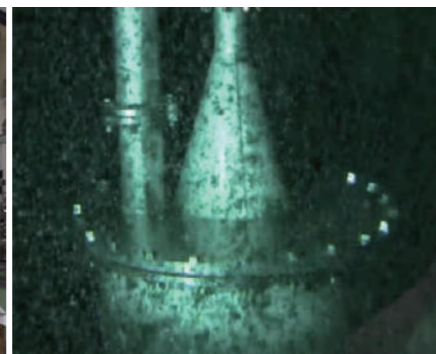
オゾン接触池内部の様子 水中にオゾンガスを溶かしています。
