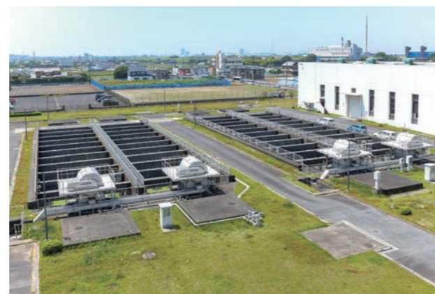
沈砂池 取水口から原水とともに流入した粒子の大きな砂などを沈降して取り除きます。
