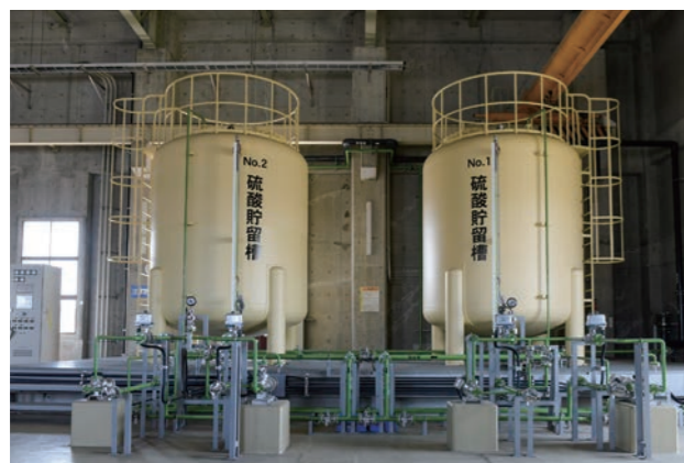
原水 pH 調整設備 凝集処理の効率向上を図るために必要に応じ濃硫酸を希釈注入しpHを調整します。
