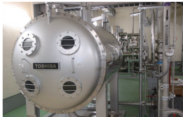
オゾン発生装置
