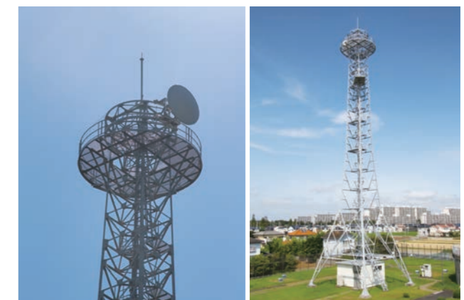
固定無線鉄塔 取水場と浄水場間を結ぶ固定無線設備(パラボラアンテナ)が設置され、浄水場から取水場内各施設を遠隔操作することができます。
