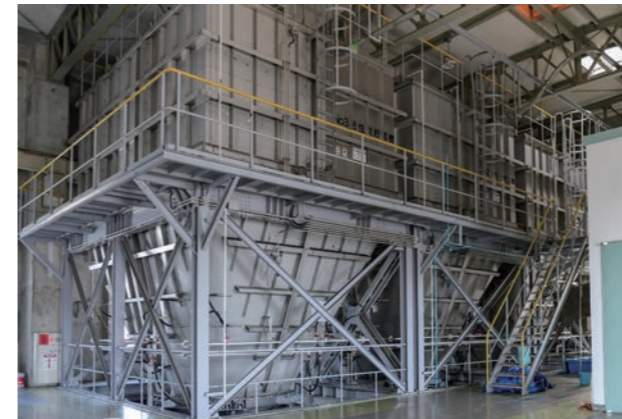
活性炭注入設備 水質事故による水質異常時や河川表流水(原水)の水質状況に応じて異臭味等の原因物質を除去するため粉末活性炭を注入します。
