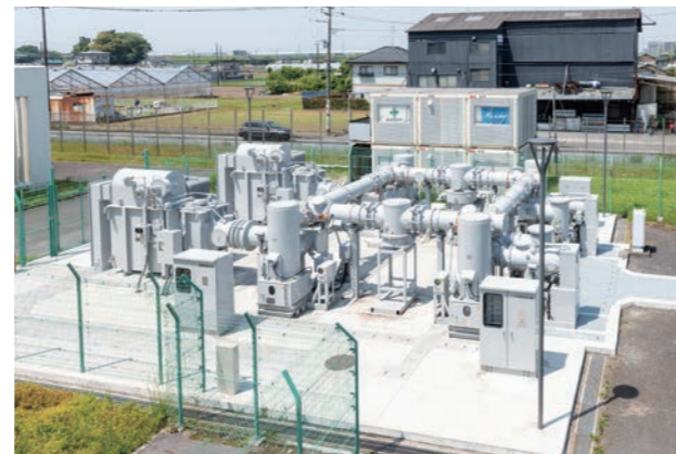
特高受変電設備 66kVの特別高圧で受電した電気を6kVの高圧に変圧して取水場内に給電します。
