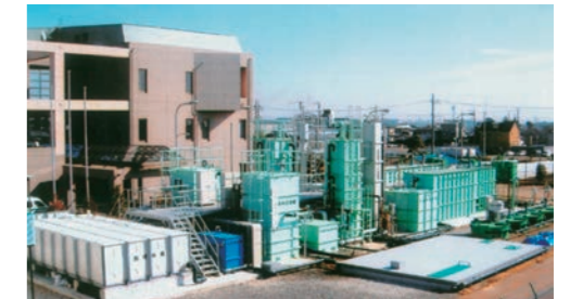
高度浄水処理大規模実験プラント H13～H17
