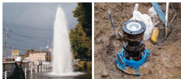
関宿線 補修弁破損 (流山市上新宿地先)
