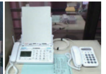
災害対策用衛星電話設備
