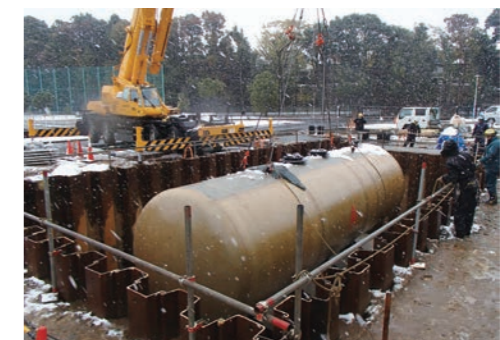
自家発電燃料タンクの増強(北千葉浄水場)
