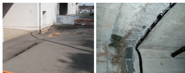
排水処理施設 陥没
