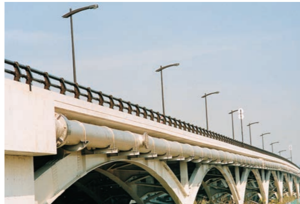
ループ化事業 手賀大橋添架管
