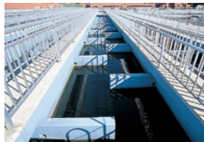
フロック形成池 原水中の濁質分を凝集するため、薬品を添加し攪拌する池。
