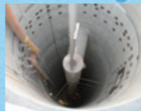
オゾン接触池 (上部から撮影) 接触水深47m
