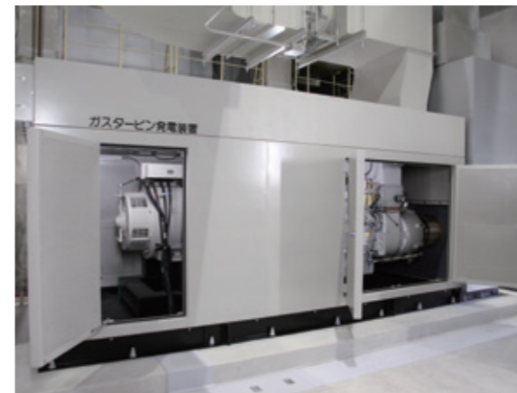
自家発電設備
