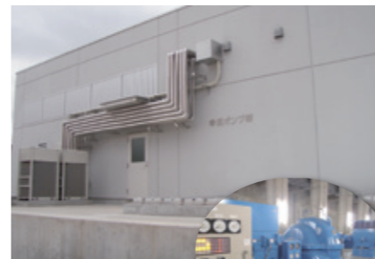
中間ポンプ施設
