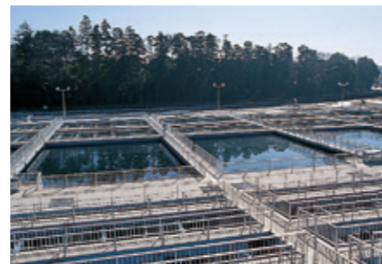
薬品沈澱池 凝集した原水中の濁質分を沈降させる池。沈降した濁質分は掻き集められ、排水処理施設に送られる。
