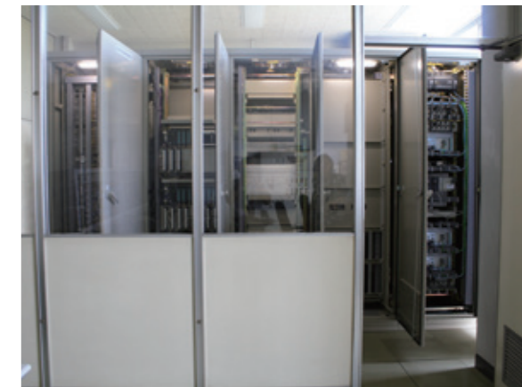
計算制御設備
