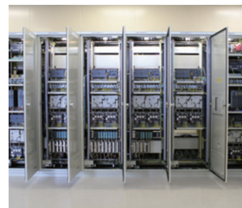
計算制御設備
