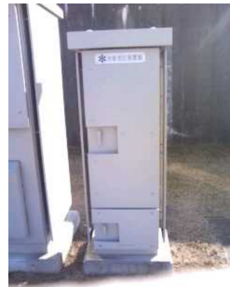
給水地点に設置した水質自動測定装置
