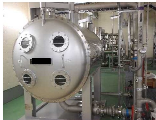
オゾン発生装置
