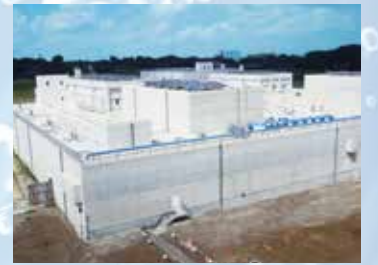
生物活性炭処理施設 (分解した有機物を吸着・除去)
