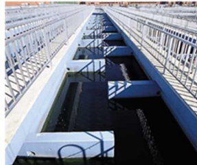
フロック形成池 原水中の濁質分を凝集するため、薬品を添加し攪拌する池で、攪拌には機械を使わない水平流式を採用している。
