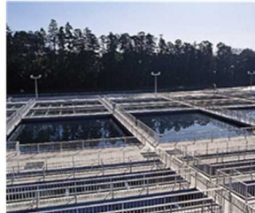
薬品沈殿池 凝集した原水中の濁質分を沈降させる池。沈降した濁質分は掻き集められ、排水処理施設に送られる。
