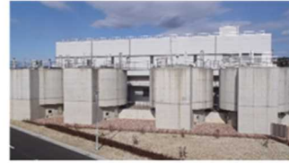
オゾン処理施設 オゾンを注入し、オゾンの強力な酸化力により有機物を分解する施設。
