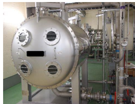
オゾン発生装置
