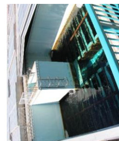
急遽ろ過池 濁質分を除いた水を飲み水とするため、砂ろ過層を通過させ浄水する池。
