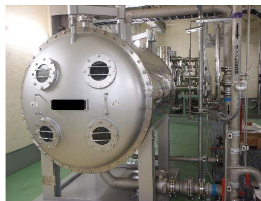
オゾン発生装置
