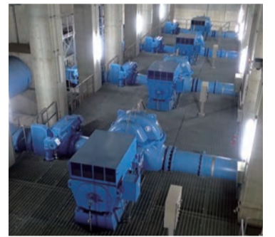
高度浄水施設(第2期) 中間ポンプ
