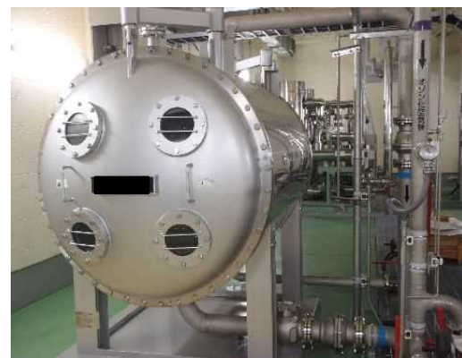
オゾン発生装置
