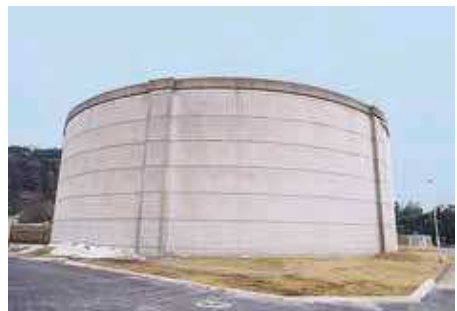
給水地点(構成団体受水槽)
