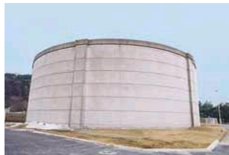
給水地点(構成団体受水槽)
