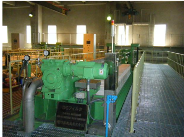
排水処理施設 脱水機（油圧式から電動式へ変更）
