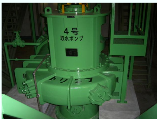
4号取水ポンプ
