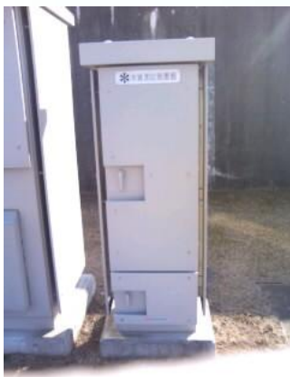
給水地点に設置した水質自動測定器
