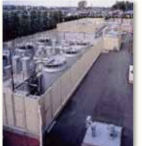
高度浄水処理施設
