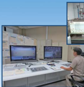
魚槽の監視 原水・浄水で金魚を飼育し、中央管理室で水質の異常の有無を常時監視しています。
