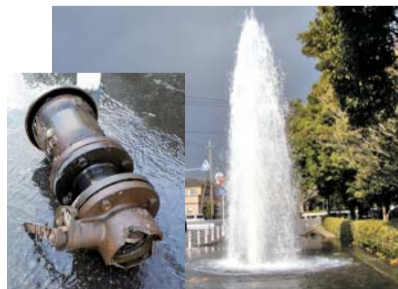
空気弁の破断による漏水
