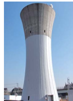
高架水槽の耐震補強(H14) 炭素繊維シート巻付けによる補強
