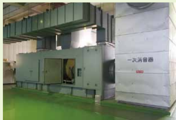
浄水場自家用発電設備
