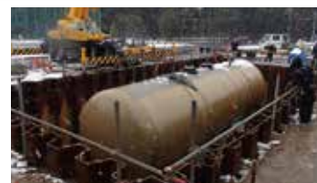
自家発電機設備の燃料貯蔵タンク
