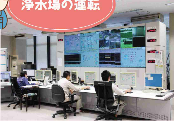
中央管理室での監視のようす
